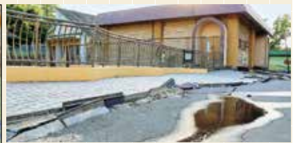
↑5 液状化現象で舗装された地面に亀裂が入った様子(熊本県、熊本市、2016年)
